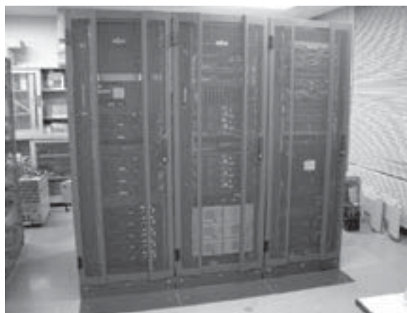
図5 サーバー群 [ラックマウント型のサーバー機器が数多く設置されています。]
